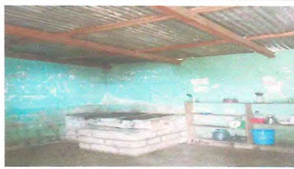
Foto 2: Techo de la cocina
