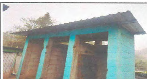
Foto 3: Puertas de los baños
