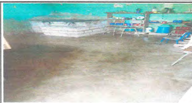
Foto 1: Piso de la cocina
